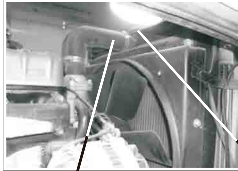
Mangueras de refrigeración revisar 250 horas (f)
