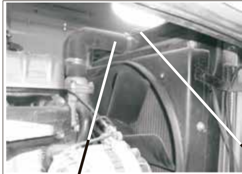
Mangueras de refrigeración revisar 250 horas (f)
